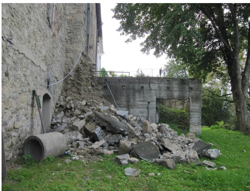
Rys. 18. Uszkodzenie kamiennej przypory zamku w Lesku, 2011 r. (fot. autorzy)
