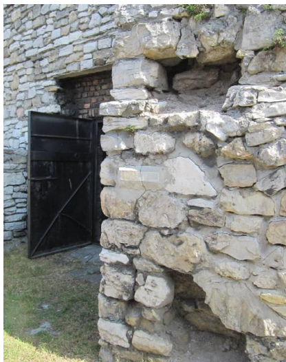
Rys. 10. Przykładowe ubytki muru przypory zamku górnego
