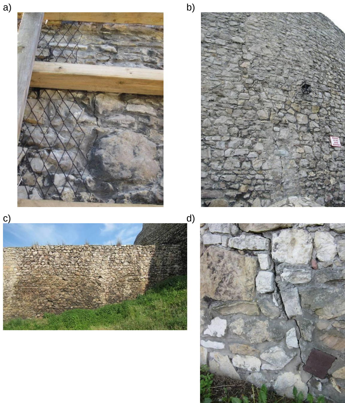
Rys. 8. Zarysowania murów zamku:
