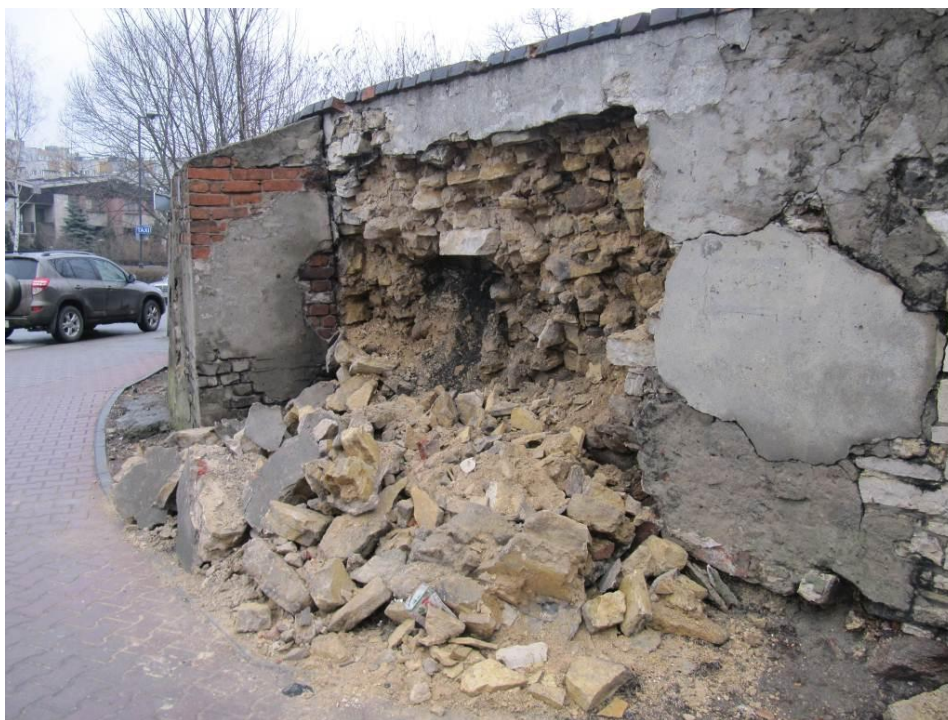
Rys. 19. Rozpad kamiennego muru przy starym kościele p.w. Św. Bartłomieja w Gliwicach, 2012 r. (fot. autorzy)
