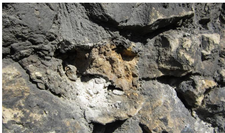
Rys. 11. Erozja kamienia i zaprawy wapiennej
