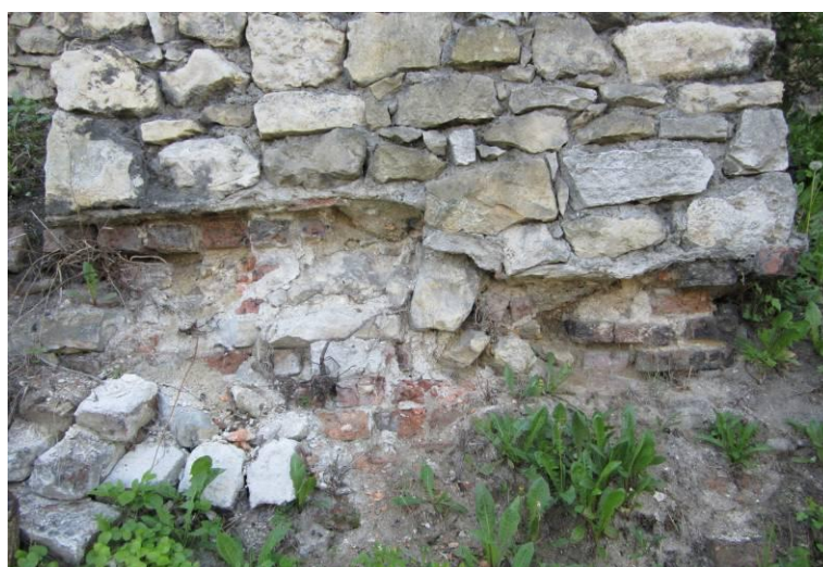
Rys. 12. Przykładowy ubytek muru przypory w strefie kontaktu z gruntem
