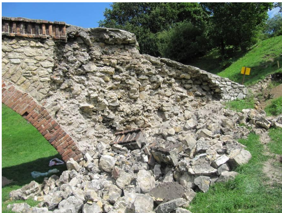
Rys. 22. Zniszczenie fragmentu arkadowego muru zamku w Będzinie, 2010 r. [2.10]
