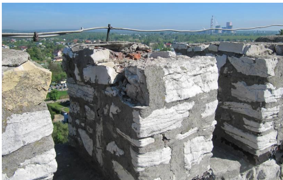
Rys. 16. Uszkodzenia krenelażu baszty okrągłej
