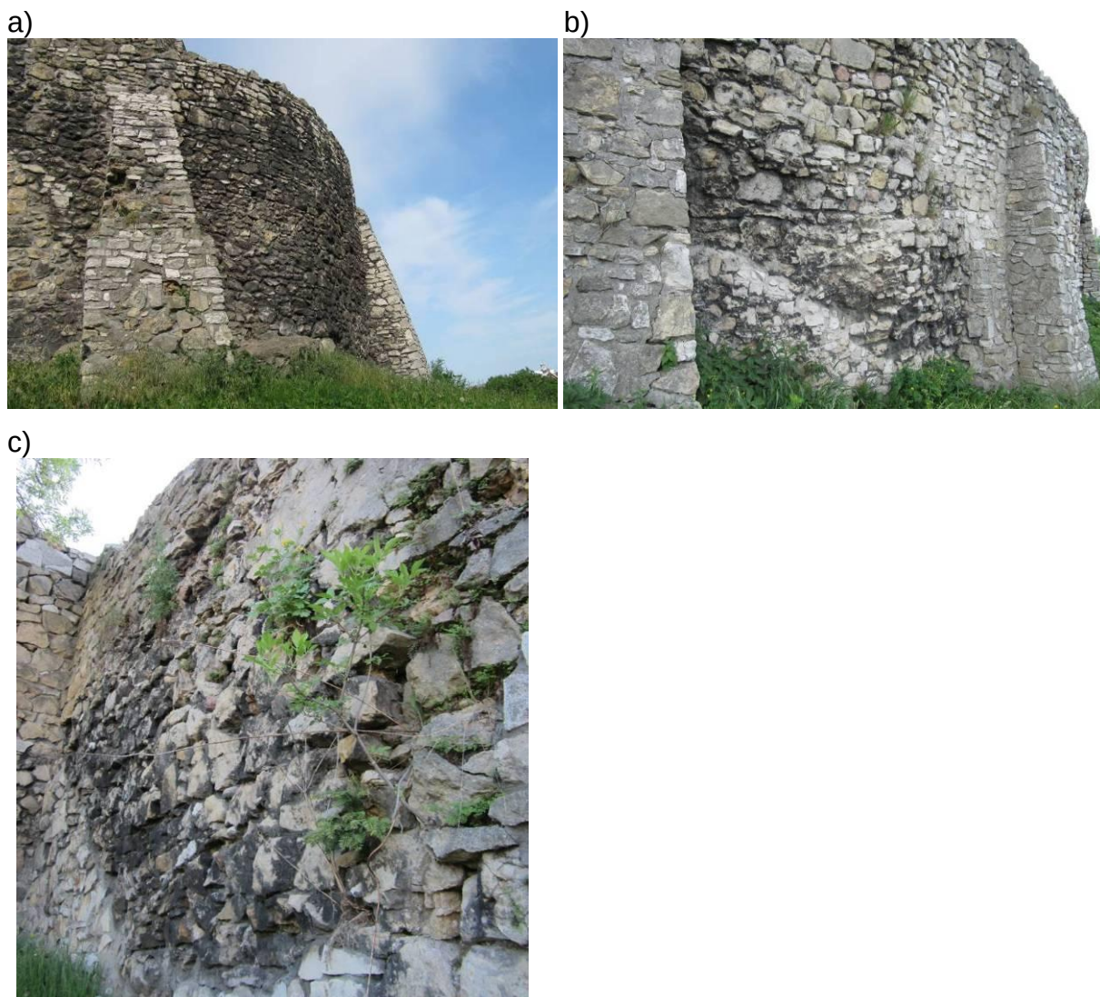
Rys. 9. Wybrzuszenia i odchylenia od pionu murów zamku: a) wybrzuszenie zewnętrznych murów zamku górnego od strony północno-wschodniej, b) wybrzuszenie i odchylenie od pionu zewnętrznych murów zamku górnego od strony północno-zachodniej, c) wybrzuszenie murów zamku dolnego w okolicy danej stajni
