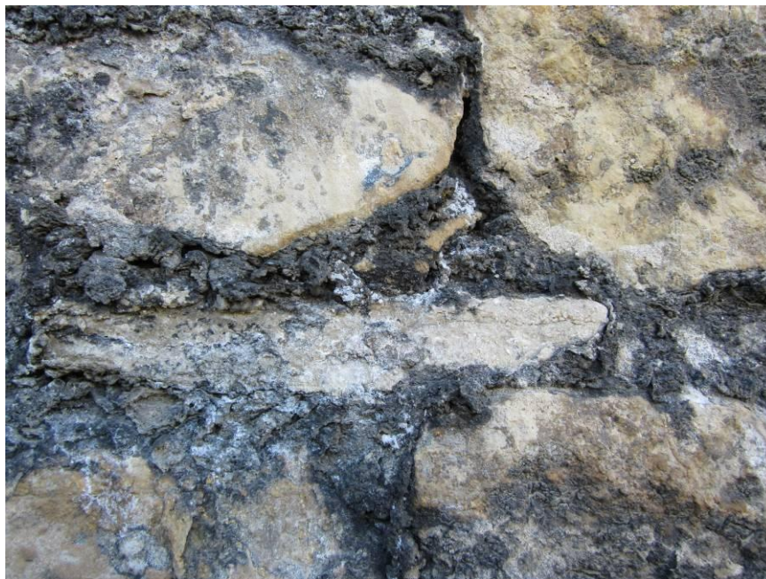
Rys. 13. Przykładowe ubytki muru przypory zamku górnego
